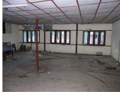
旧教員室棟。木造柱が座屈し、 倒壊の可能性が高く、現在は 使用禁止。
